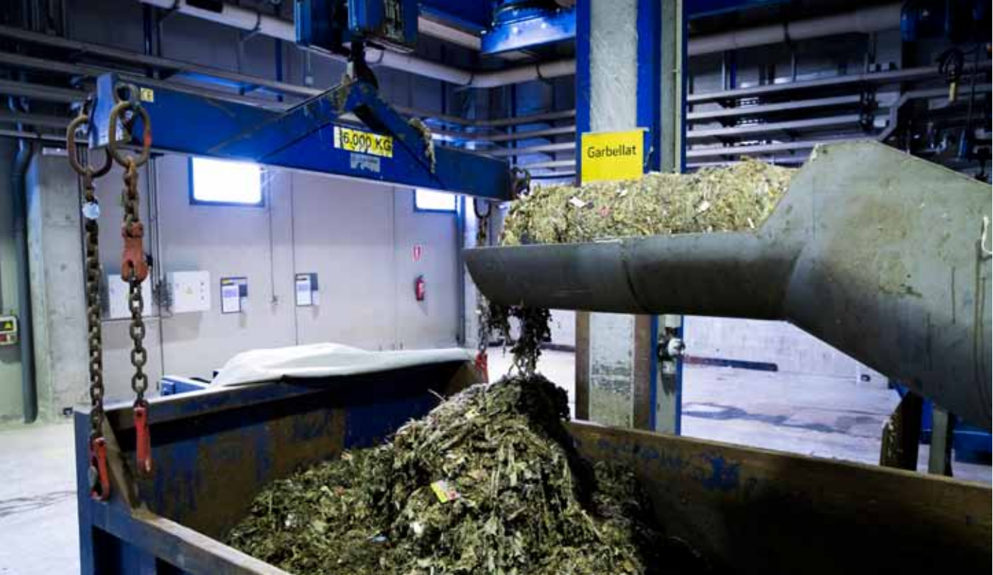
IMATGE IMPACTANT Contenidor a l’EDAR Besòs amb residus sòlids abocats a la xarxa de sanejament.
