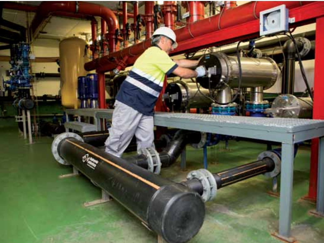
17:00 hores. Un operari es desplaça a una instal·lació d'aigua no potable de l'Hospitalet de Llobregat per comprovar el correcte funcionament del sistema de desinfecció.
