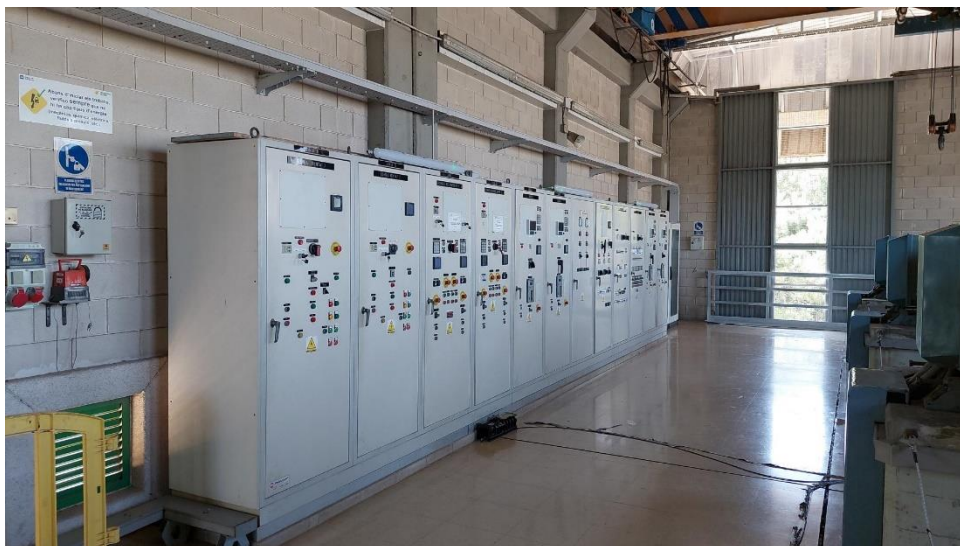
Quadre elèctric del B.I.
