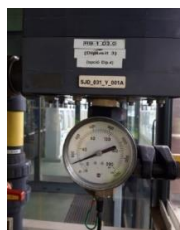
Vàlvula de buit de la instal·lació de clor de l'ETAP de St Joan Despí
