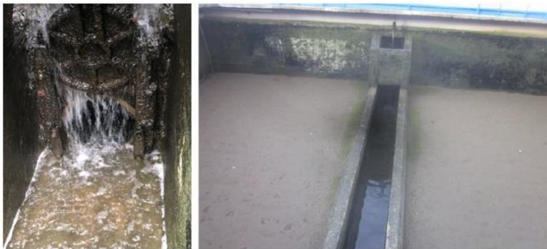
Comporta de desguàs de filtre de sorra
