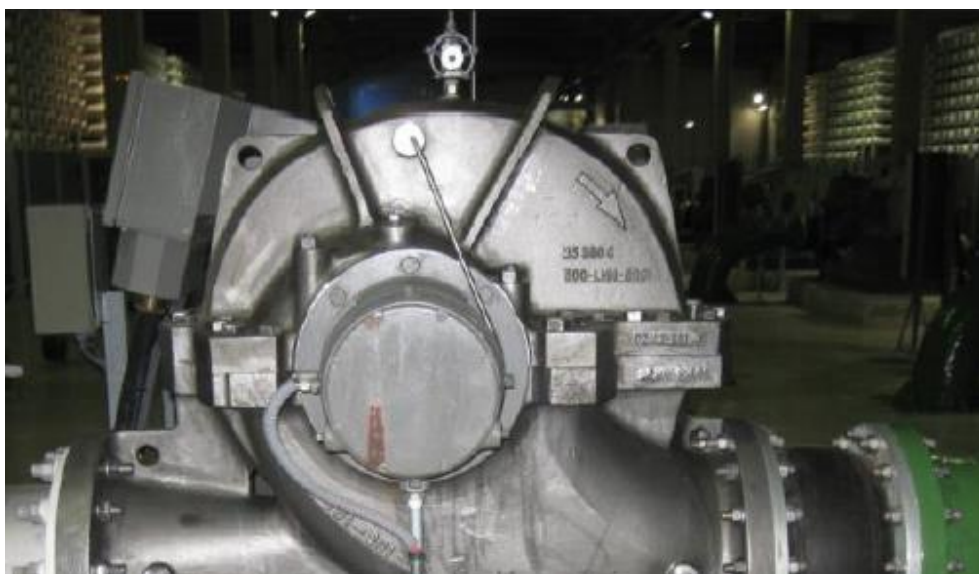
Grup de bombament a membranes O.I a S.J.D
