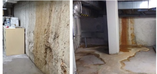
Exemple d'oxidació en un dels passadors que uneix dos forjats a banda i banda de una junta.
