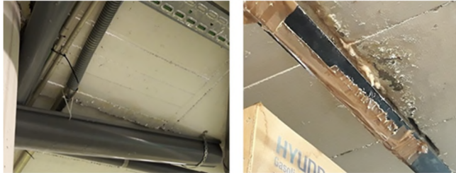
Exemples de filtracions a les pantalles perimetrals
