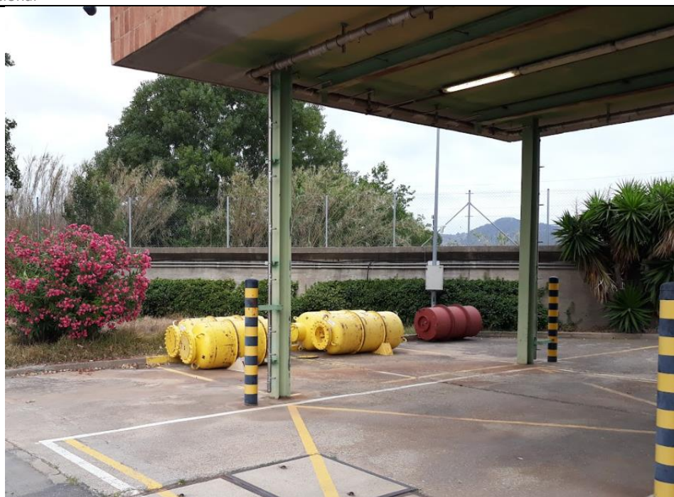
Zona on cal evacuar l'aigua de la cortina per fuites de clor
