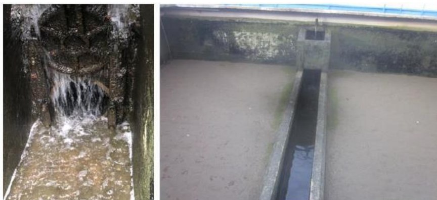
Comporta de desguàs de filtre de sorra
